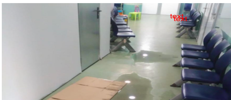
Restos de las goteras en el centro de salud de Pere Garau.
